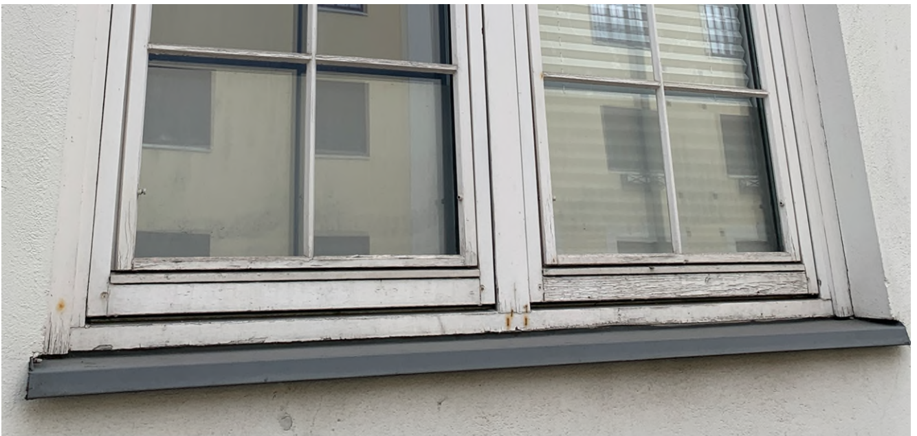
Bilde 4 – Nærbilde av nedre del av sidehengslet vindu. Tydelige tegn på elde og maling som flasser. Ved manglende utbedring vil fukt trekke inn i trevirke med tilhørende råteskader innen få år.
