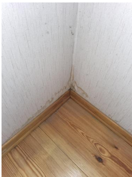
Våtrom - [TG3 bad, synlige fuktmerker bak badene ved stue]
