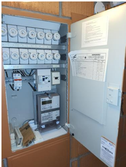
Elektrisk anlegg - [Sikringsskap]
