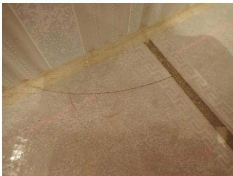
Det er sprukne fliser på gulv ved yttervegg.
