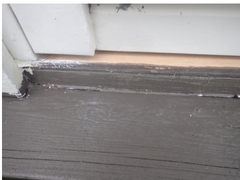
Det er påvist feil ved oppkant ved terskel balkongdør i 2. etasje.
