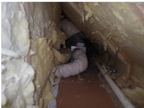
Tilgang til kryploft. Ventilasjonsagregat.
