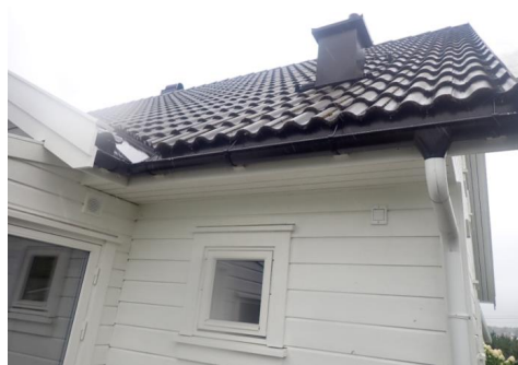
Tak på side inngangsparti mangler snøfangere.
