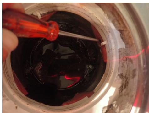
Det er påvist synlig membran i sluk under klemring.
