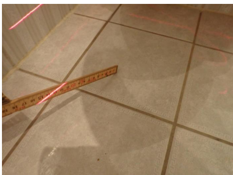
Det er bom/hulromslyd på flere gulvfliser.
