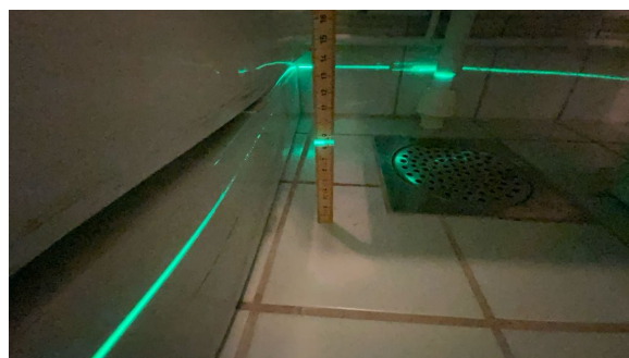
Høydeforskjell (ved sluk)
