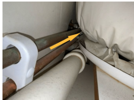
Stoppeventiler på kjøkken
