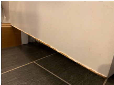
Baderomsdøren er noe fuktskadet nederst
