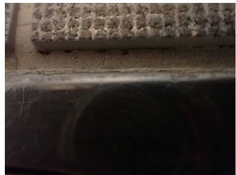
Riss i fuger ved sluket
