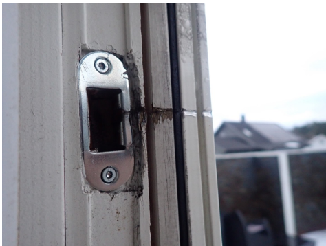
Skade på terrassedør
