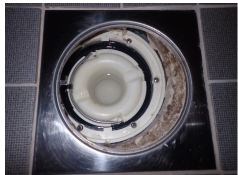
Det er påvist synlig membran i sluket.
