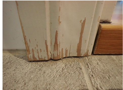
Synlig fuktbelastning på dørlist nedre del mot gulvet.
