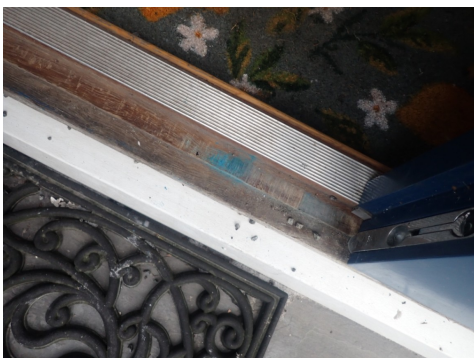
Inngangsdør subber mot terskel
