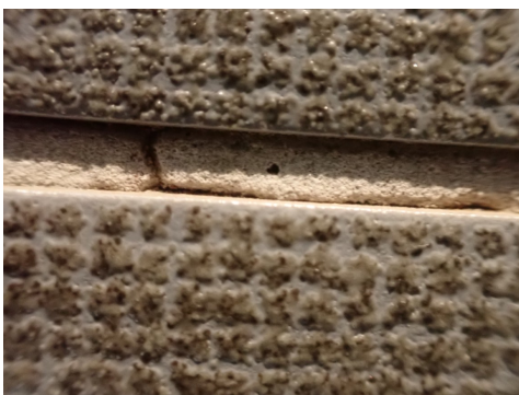
Enkelte riss på vegger i dusj
