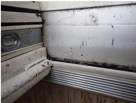
Skadet tettelist og slitasje på terrassedør.
