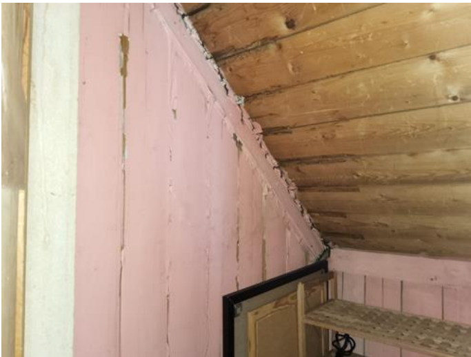
Kommentar - [Fuktskade himling]
