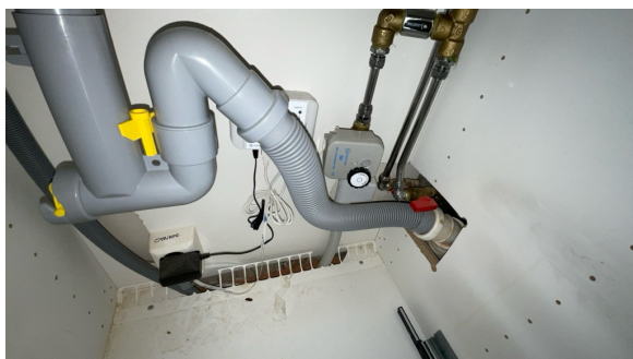
Rørapplegg på kjøkken.
