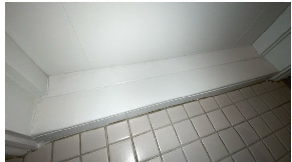
Luftespalte mellom dørterskel og dørbild mangler.
