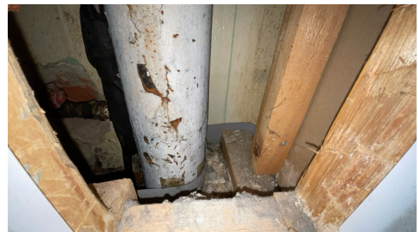
Stoppekran er til venstre for avløpsrøret.
