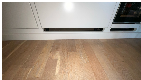
Utkast for avtrekksluften er i sokkelen under komfyren.
