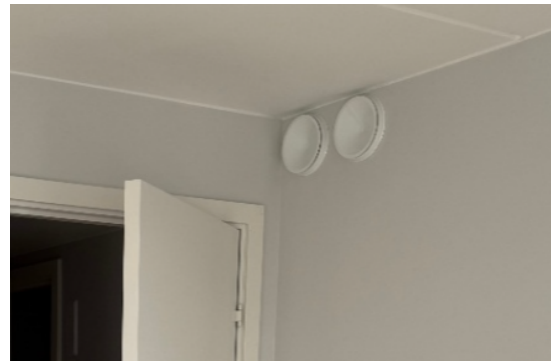
Ventiler i stue
