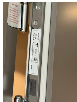
Merke for brannklasse på inngangsdør
