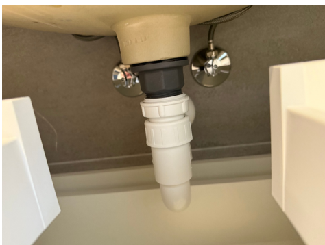
Rør i innredning bad
