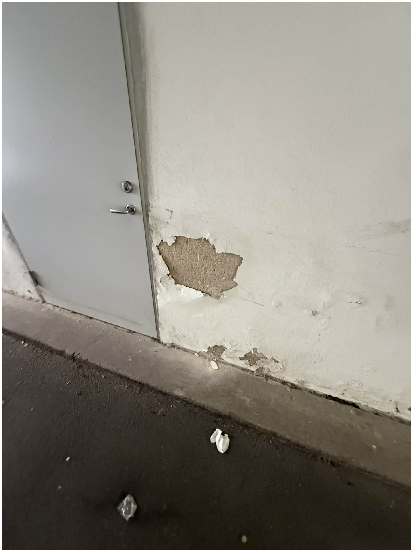
Vedlegg: Oppgradering av inngangsparti - Avskalling på vegg 3.jpg
