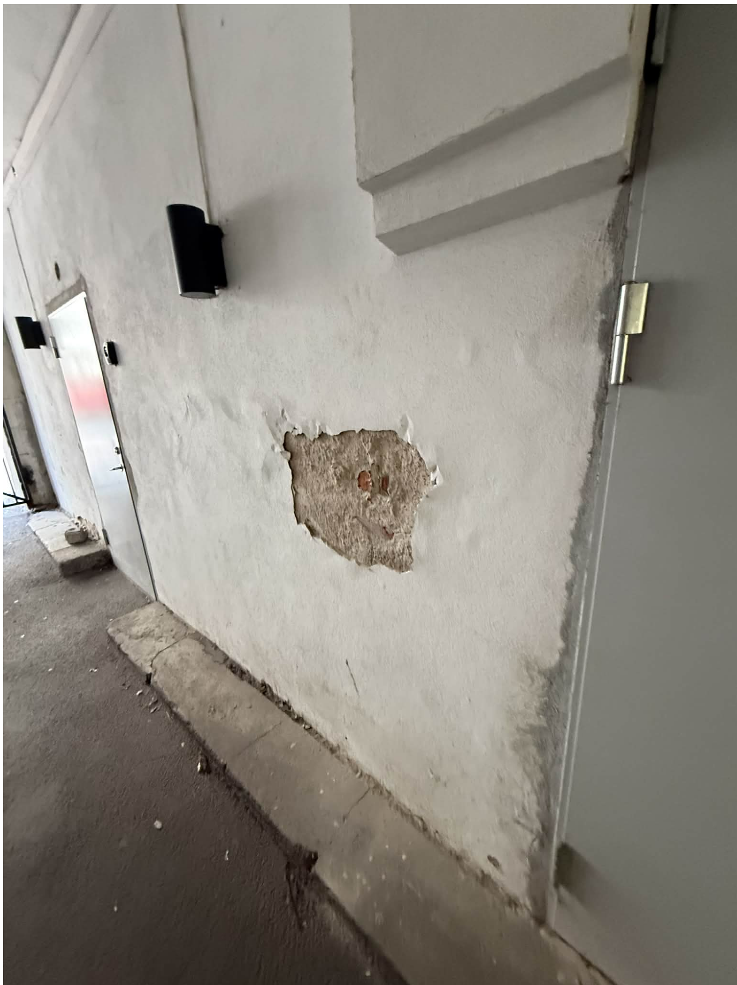
Vedlegg: Oppgradering av inngangsparti - Avskalling på vegg 2.jpg
