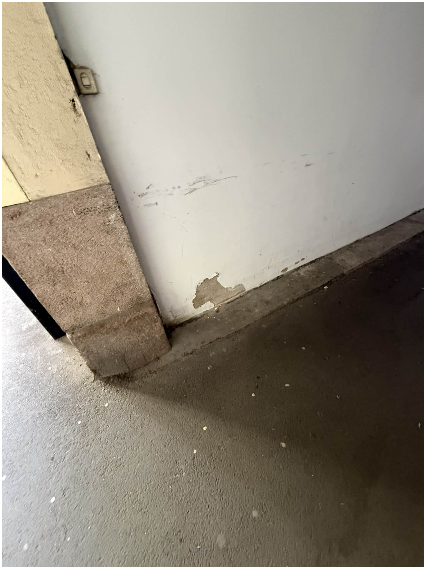
Vedlegg: Oppgradering av inngangsparti - Avskalling på vegg 1.jpg
