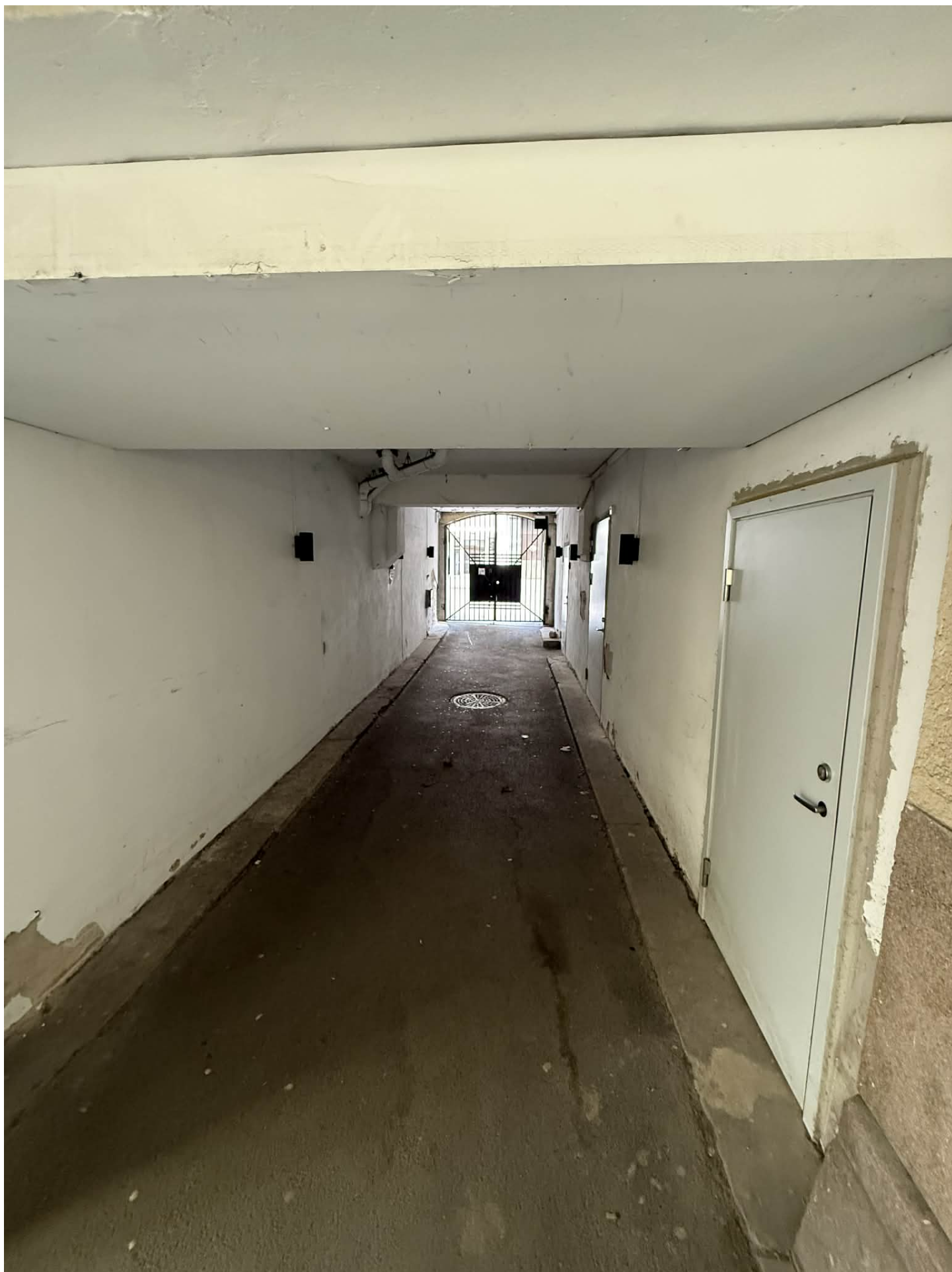
Vedlegg: Oppgradering av inngangsparti - Generell tilstand i gjennomgang.jpg
