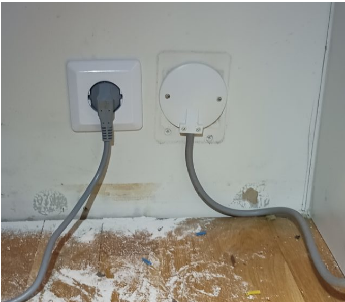
Bilde 2 Til info: Stikkontakt for oppvaskmaskin er plassert bak maskin.
