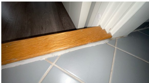
Overgang ved dørterskel.
