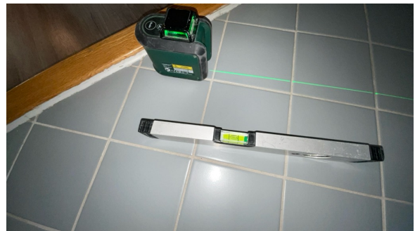
Motfall i retning sluk ved dørterskel.
