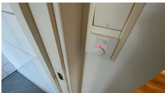
Termostadbryter til varmekabler.
