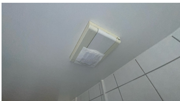
Test med løst ark viste fungerende avtrekk men svakt.
