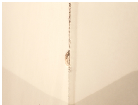
Åpen fuge i hjørne dusj.
