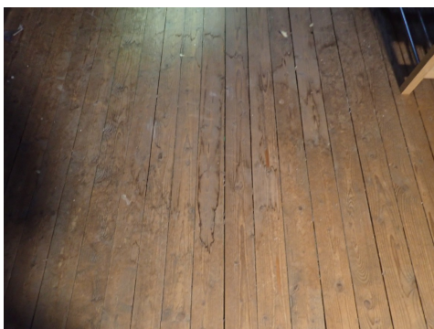
Skjolder på gulv loft
