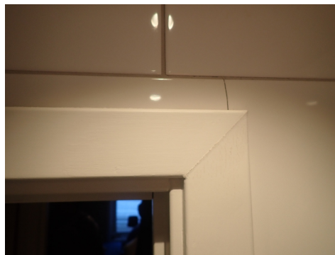
Skadet flis ved dør høyre side
