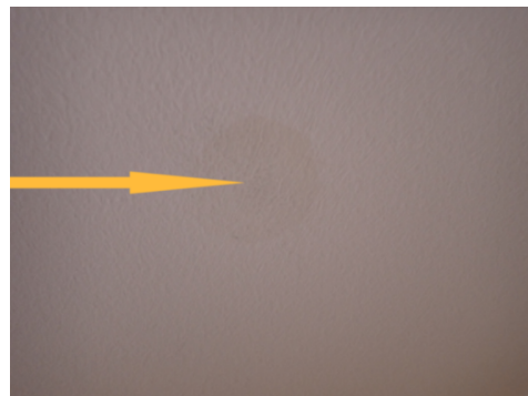
Synlig skjolder i himling stue hjørne under loft der lekkasje er påvist
