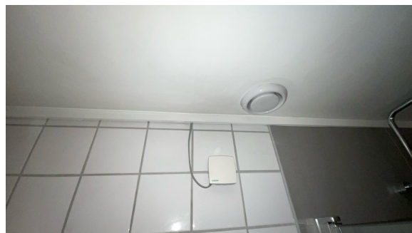
Test med løst ark viste tilfredstillende avtrekk.
