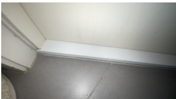
Ingen luftespalte under dørbildet.
