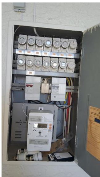
Elektrisk anlegg - [Sikringsskap]
