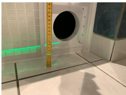
For lite fall på gulv fra dør mot sluk
