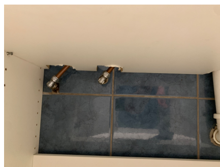
Det mangler tetting rundt rørgjennomføringer for servant
