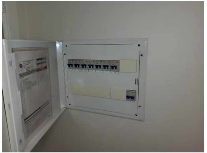
Elektrisk anlegg - [Sikringskap. ]
