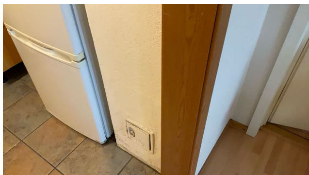
Pipeløp underetasje. To sider er tildekket.
