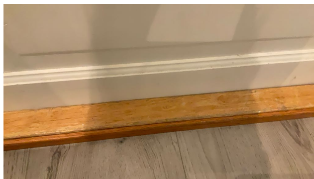
Tett under dørblad. Vaskerom mangler tilluft
