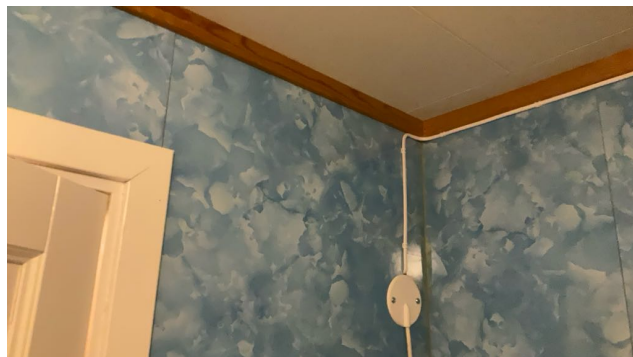
Plater med stedvis synlig slitasje
