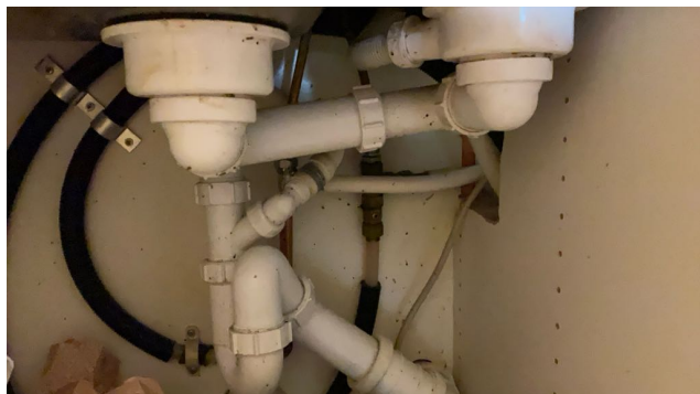
Avløp vask kjøkken utleie.
