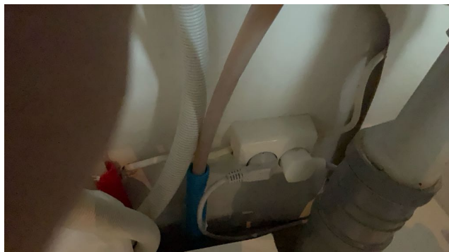
Mangler tettemuffer på enden av trekkerør
