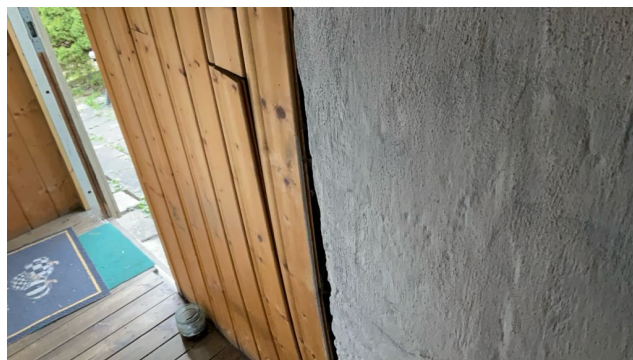
Synlig skjevheter vegg
