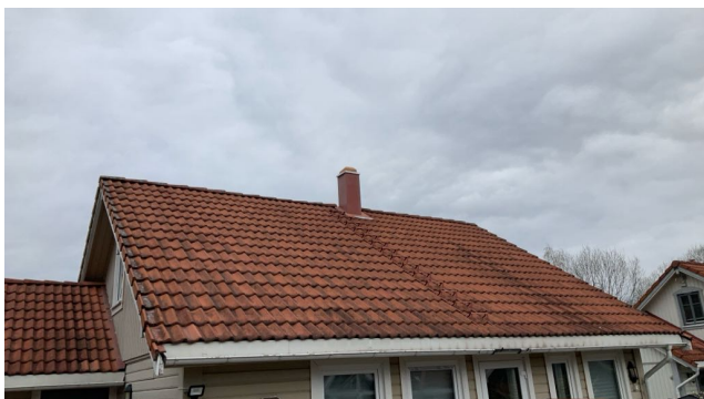
Det mangler snøfangere på taket
