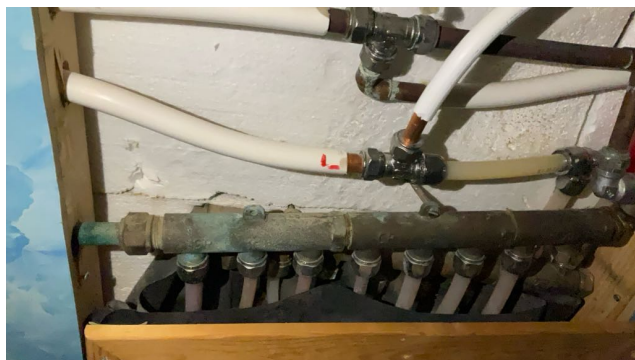
Fordelerstamme i teknisk rom. Mangler kursfortegnelse.
