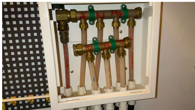
Fordelerskap i bod kjeller. Mangler kursfortegnelse
