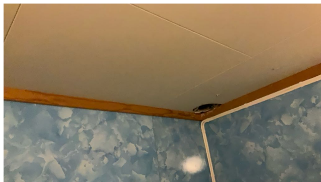
Hull i tak hjørne
