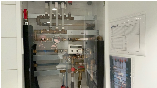
Fordelerskap i bad
