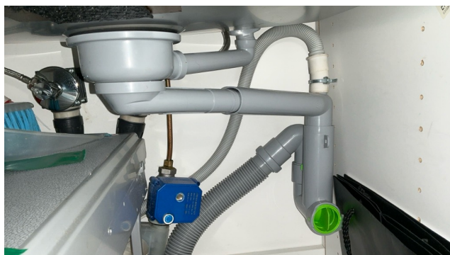
Avløp vask kjøkken
