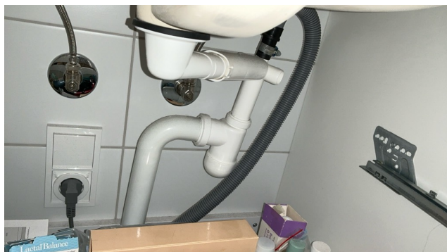
Avløp servant bad
