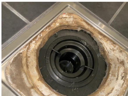
PVC sluk med synlig membranmansjett montert under klemring til sluk.
