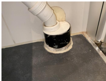
Membranoppkant på rørgjennomføring som er under 25 mm.
