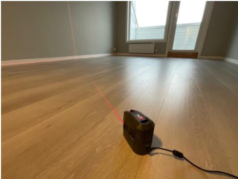
Nivellering stue/kjøkken, avvik ca. 15-30 mm
