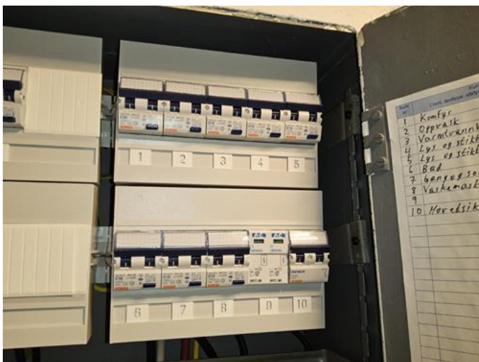
Elektrisk anlegg - [Sikringsskap. ]
