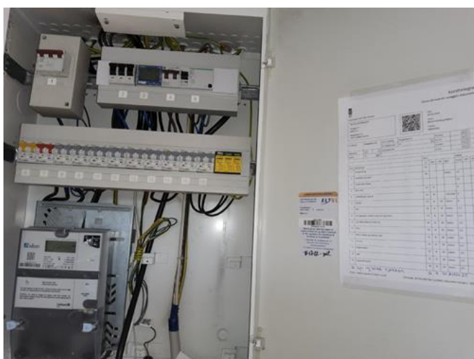
Beskrivelse - [Sikringsskap med kursfortegnelse, hoveddel. ]
