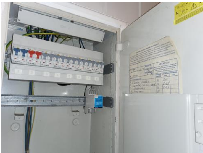
Beskrivelse - [Sikringsskap med kursfortegnelse, underetasje. ]
