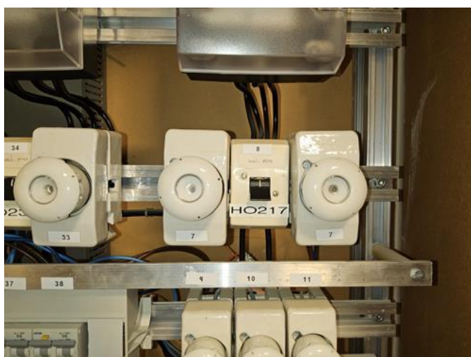
Elektrisk anlegg - [Sikringsskap]
