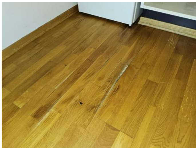
Overflater gulv - [Svelleskader parkett ved kjøkken]
