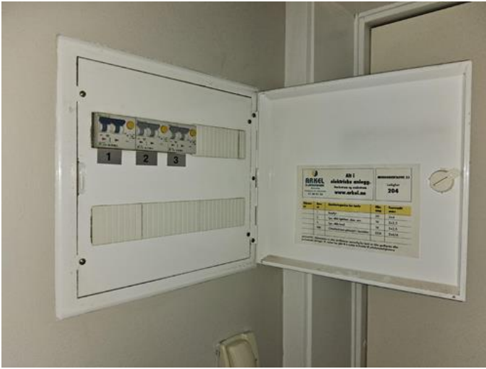
Elektrisk anlegg - [Sikringskap. ]
