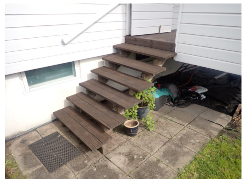
Trapp mangler rekkverk
