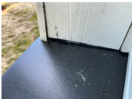
Manglende oppbrett på beslag
