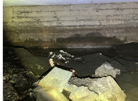
Større vannansamlinger i det ene rommet i krypkjelleren
