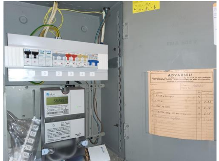
Elektrisk anlegg - [Sikringsskap ]
