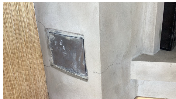
Sprekk i pippe.
