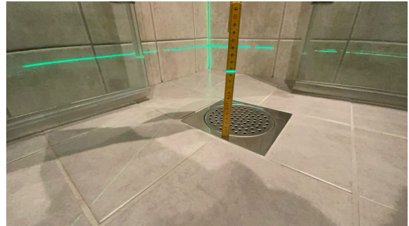
Høydeforskjell (ved sluk)
