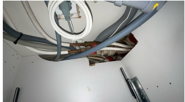
Stoppeventiler på kjøkken
