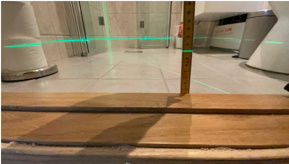
Høydeforskjell (flis ved terskel)
