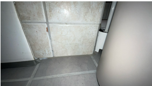
Sprekk i flis
