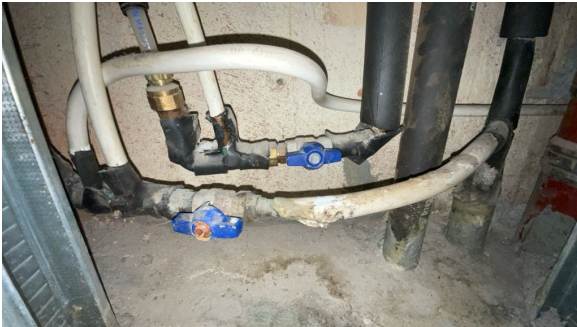
Stoppeventiler på bad
