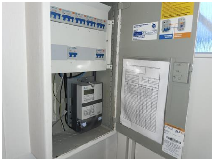
Elektrisk anlegg - [Sikringsskap ]
