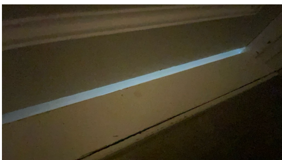
Luftespalte under dørrbladet.
