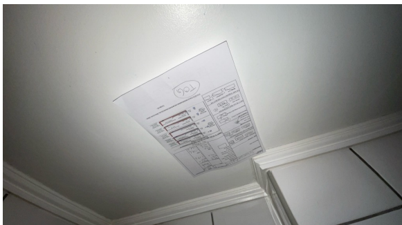
Test med løst ark viste tilfredsstillende avtrekk.
