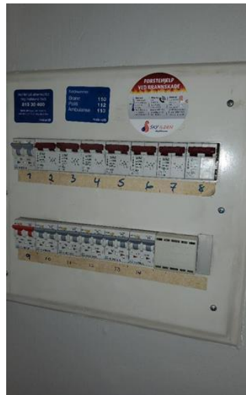
Elektrisk anlegg - [Sikringskap ]
