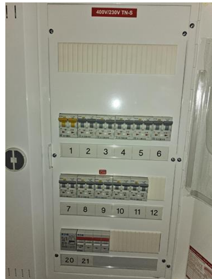
Elektrisk anlegg - [Sikringskap]
