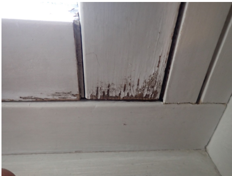
Skadet overflate på terrassedør.
