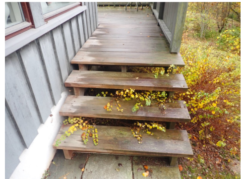
Trapp mangler rekkverk.
