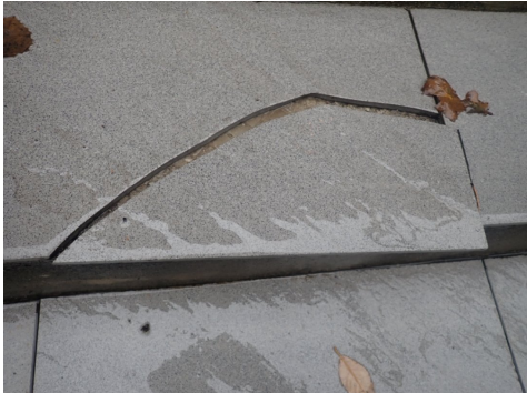
Fliser har sprukket
