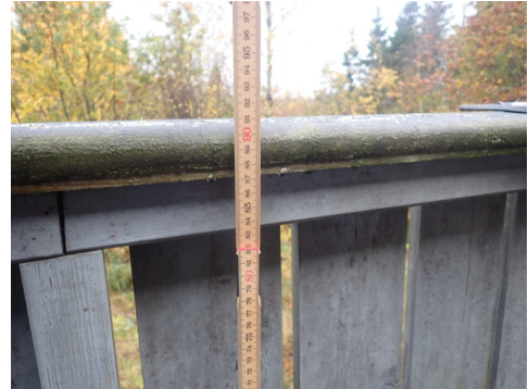
Rekkverk terrasse 90 cm høyde.
