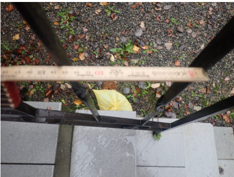
Åpninger i rekkverk er ikke i henhold til krav i dagens forskrifter. (max 10 cm)
