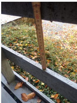
Åpning i rekkverk på balkong er ca. 19 cm.
