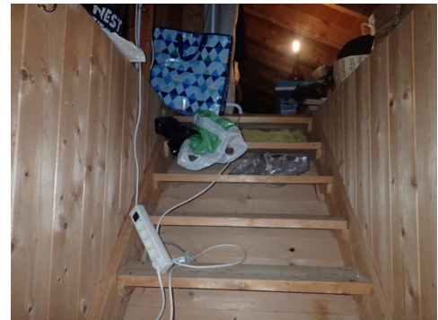
Synlige skjøteledninger på loftet.
