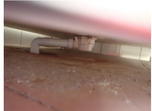
Sluk under dusjkabinett. Sluk er ikke mulig og undersøke
