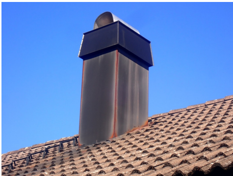
Pipebeslag har tydelig rustutslag på overflaten
