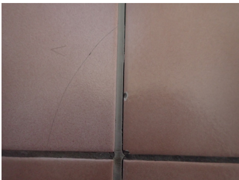
Flere fliser på gulv har sprukket og skadet
