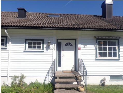
Det mangler snøfangere på deler av taket
