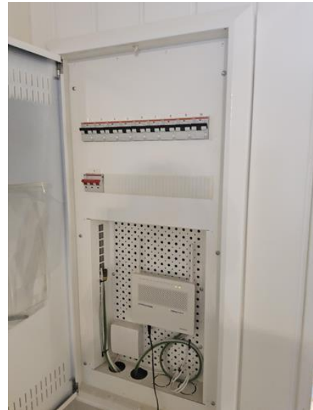
Elektrisk anlegg - [Sikringskap]
