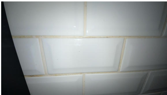
Riss i fuger
