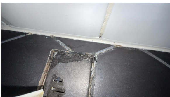
Riss i fuger/løs flis
