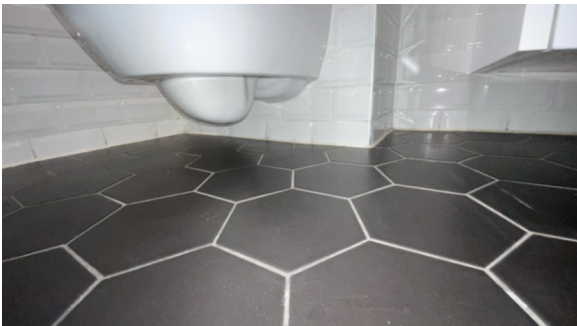
Ingen spalte for sikring av lekkasjevann
