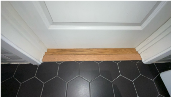
Ingen spalte for tilluft
