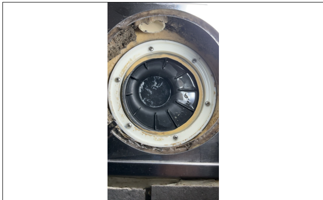
Sluk på bad
