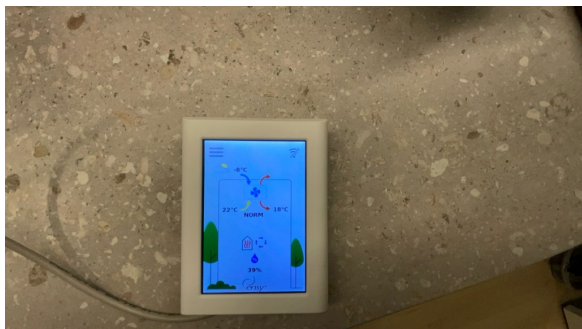
Styringspanel til ventilasjonsaggregatet.
