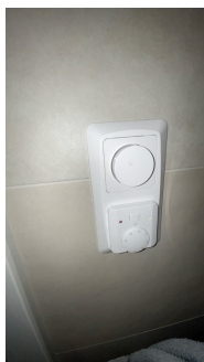
Termostatbryter for vannbåren gulvvarme.
