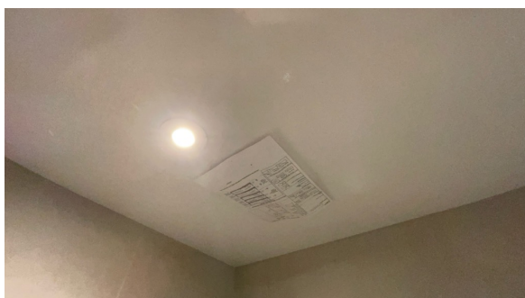
Test med løst ark viste tilfredstillende avtrekk.
