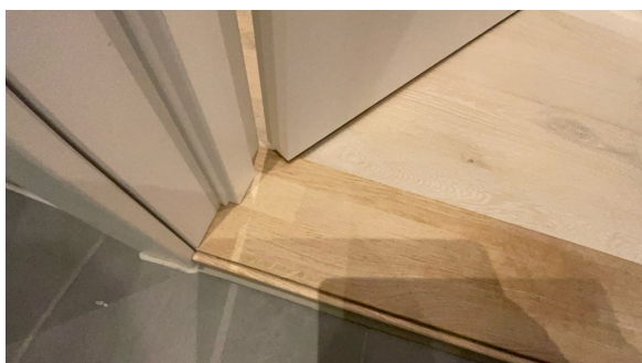
Luftespalte under dørbildet.
