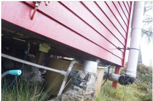
Avløpsrør og vannrør.
