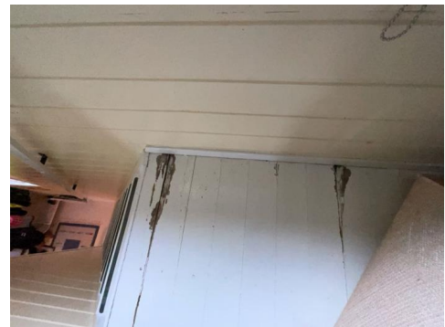
Fuktskadet/slitt gulvbord ved trapp på loft.
