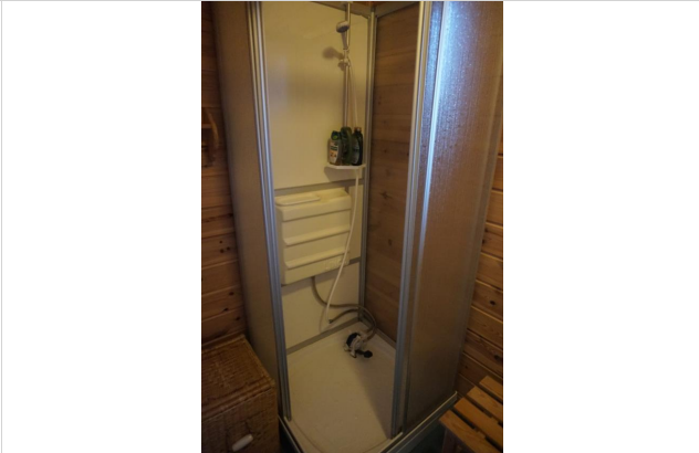
Dusjkabinett med fotpumpe.
