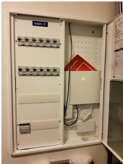
Elektrisk anlegg - [Sikringsskap]
