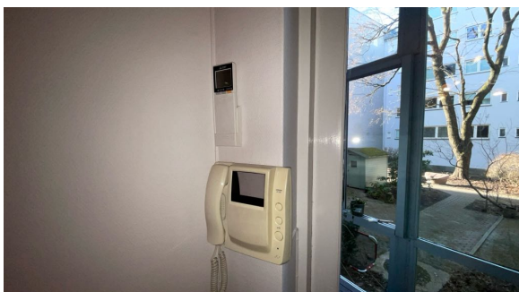
Dørcalling er plassert ved balkongdør.
