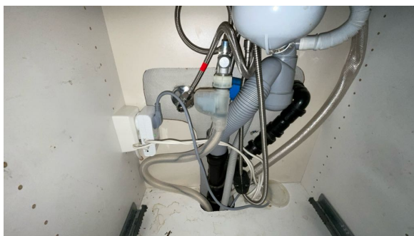
Røropplegg på kjøkken.
