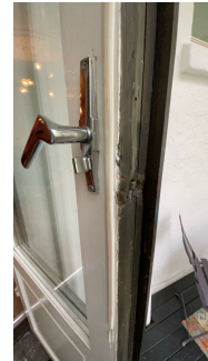
Skader i dørbladet rundt låskassen.
