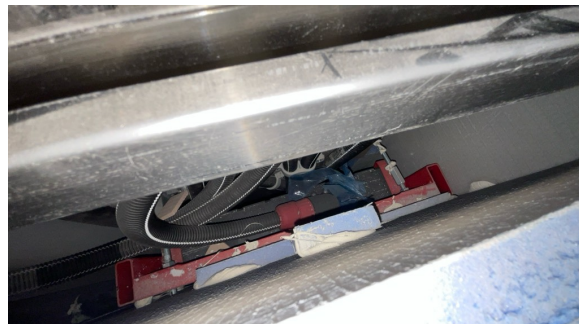
Det er trolig intern avrenning fra fordelerskap.
