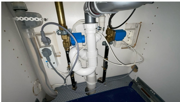
Lekkasjestoppere på kjøkken.
