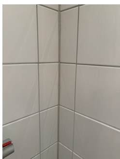
Tidligere skruehull er silikonert etter takstbefaring.
