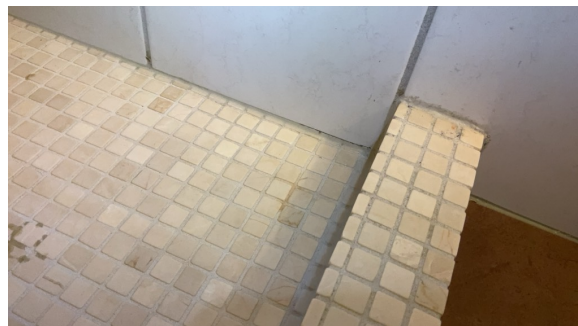
Sprekk i fuging.
