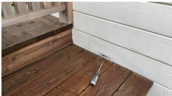
Råte i bord ved inngangsparti.
