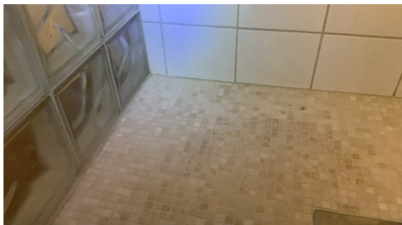
Sprekk i fuging.
