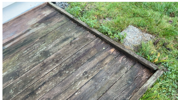
Råte i golv.
