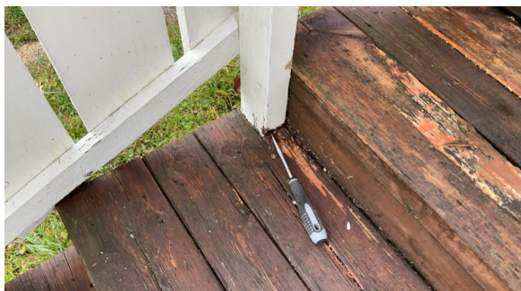
Råte i stolpe.
