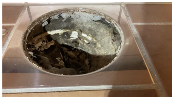
Sluk under servantskap.
