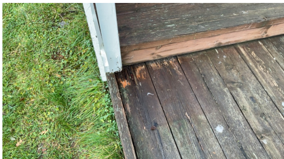
Råte i golv.
