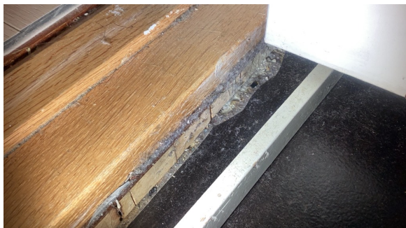
Ingen oppkant mot terskel.
