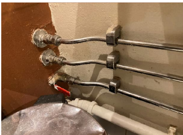
Vannrør og stoppekran i bolig
