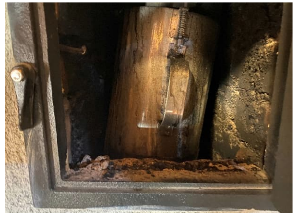
Syrefast stålrør i pipe
