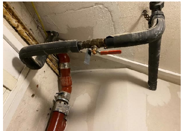
Avløpsrør av MA og kuleventil på vannrør
