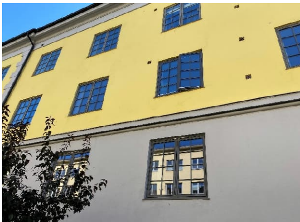
Tilluftsventiler i yttervegg
