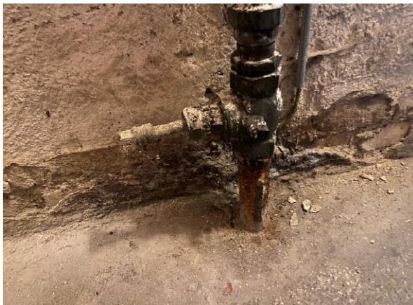
Vanninnlegg og stoppekran fra byggeåret
