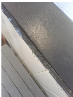
Ytterkledning (fasademateriale, vannbord, utvendig listverk, o.l.) - Utett overgang mellom beslag/trekledning på balkong
