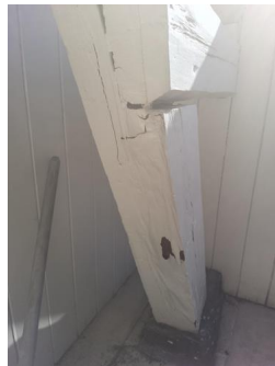
Konstruksjon og fundamenter - Råteskader i bærende konstruksjoner
