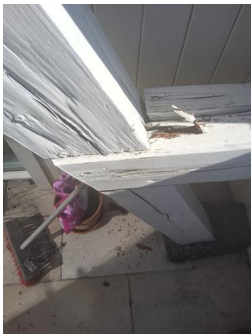
Konstruksjon og fundamenter - Råteskader i bærende konstruksjoner
