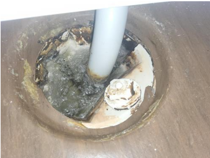
Kommentar - [Sluk bad 1.etasje ]
