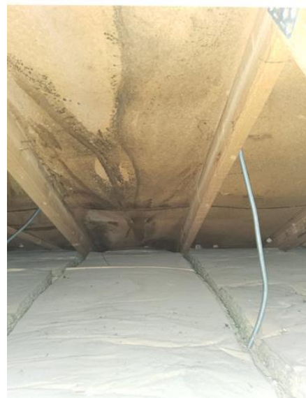
Kommentar - [Fuktmerker undertak råloft ]
